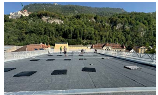
Die Anlage auf dem Haus Äule konnte Ende Oktober ihren Betrieb aufnehmen.
