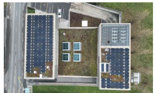
Blick von oben: Unsere Fotovoltaikanlage auf dem Dach unserer Geschäftsstelle in Eschen.
